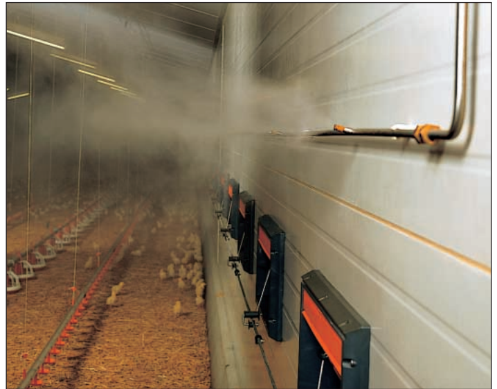
Fogging Cooler rendszer használata brojler istállóban
